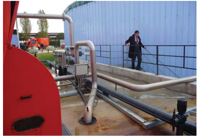
▲ La biomassa uscita dal REFINER attraverso un complesso di tubazioni passa alla sottostante pre-vasca
