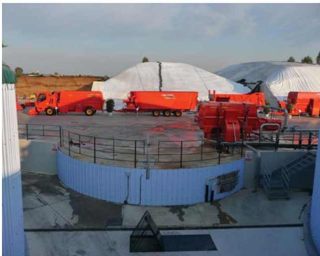
▲ A destra di colore arancione il Refiner e al centro la prevasca interrata di forma semicircolare. Dalle scale di destra si scende nella piazzola di ingresso alla sala tecnica posta al centro del quadrilatero formato dai 4 digestori
