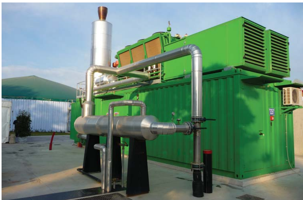
▲ Il motore a gas alimentato dall'impianto che a sua volta produce energia elettrica messa in rete, è particolarmente silenzioso, viene prodotto dalla società Jenbacher
