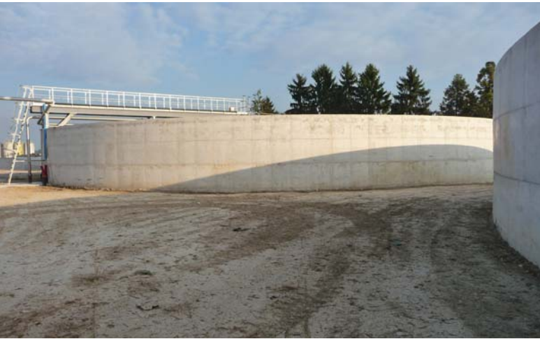
▲ Le vasche di stoccaggio del digestato liquido
