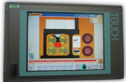
▲ In una stanza della sala tecnica è stato installato il sofisticato sistema di controllo e di gestione automatica con un software appositamente progettato. Ecco il quadro di controllo a touch screen
