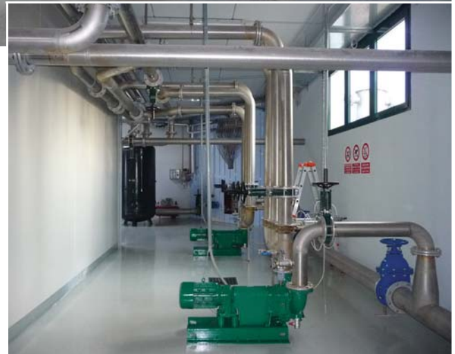
▲ La sala tecnica dell'impianto SEKO è di grande ampiezza e di facile accesso, molto funzionale, con una serie di dotazioni tecnologiche di ultima generazione
