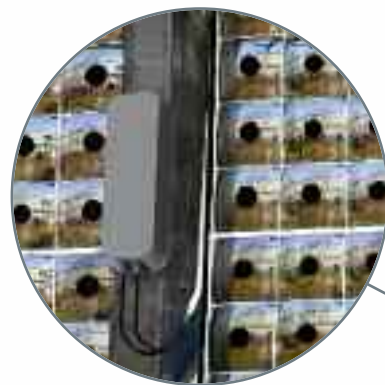
Inverter indipendente posizionato sul retro di ogni singolo modulo
